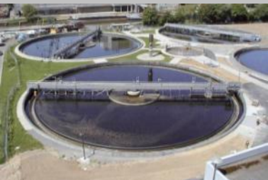
Vann- og avløpsbehandling
