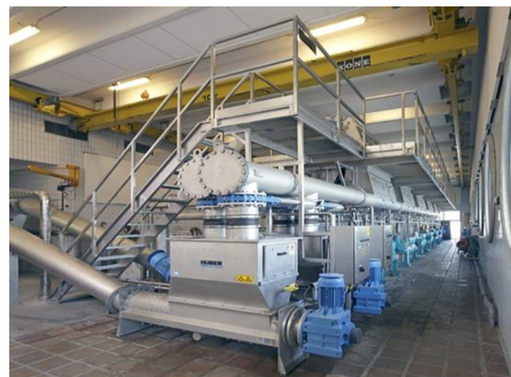
Launder kanal (Vaskekanal fra rister til vaskepresse)
