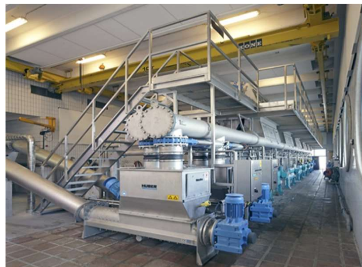
Laundry kanal (Vaskekanal fra raster til vaskepresse)
