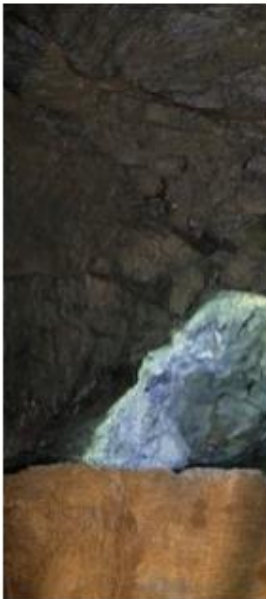
SPREKKER I TAKET: Varaordfører sprekker i taket.
